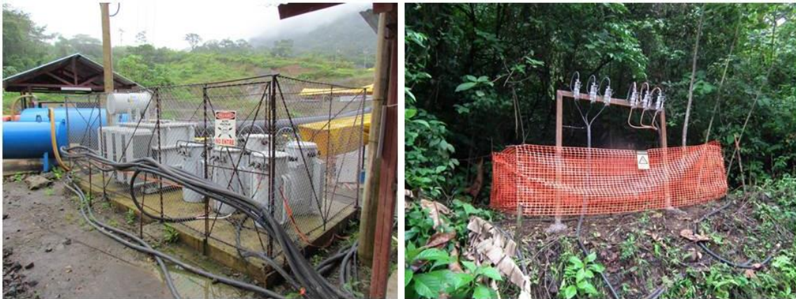
Figura 9. Barreras perimetrales que no contemplan medidas de prevención de electrocución (imágenes fuente CNFL).
