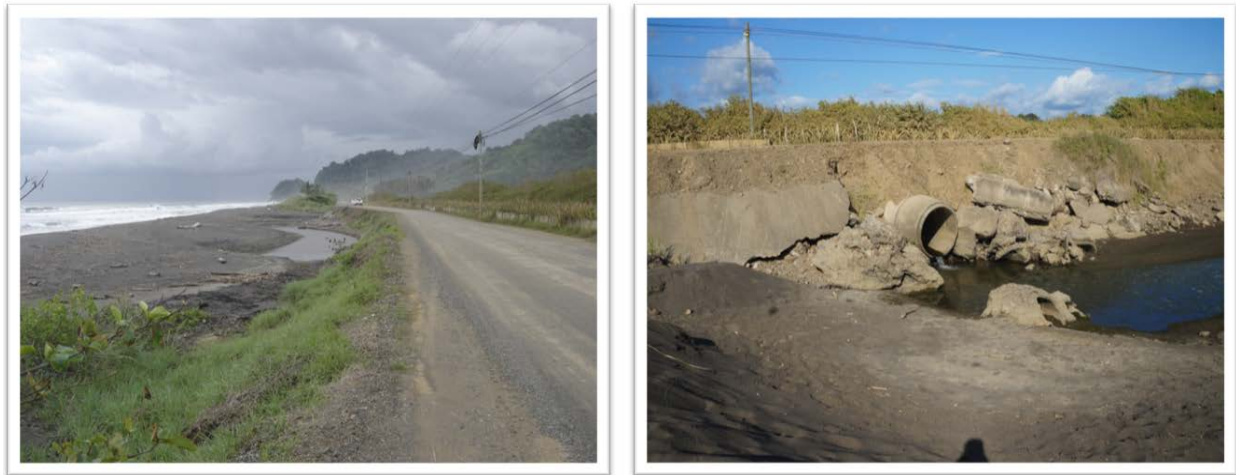
Figura 8. Camino público donde el Refugio perdió la berma de la playa y zona crítica ante el aumento del nivel del mar
